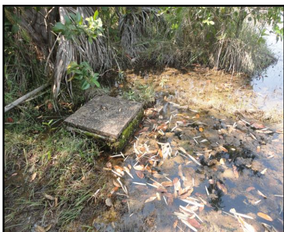
Caixa de visita
