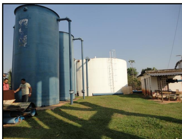
ETA–Estação de tratamento d'água
